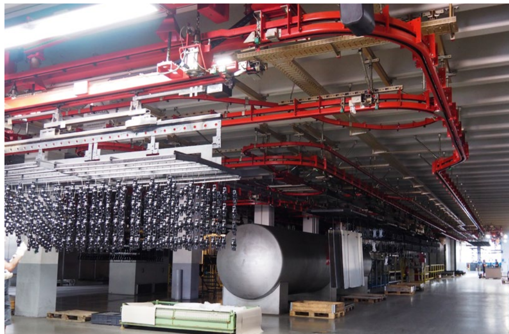
Die P&F-Förderung der KTL-Anlage hat eine Länge von etwa 1,2 km.
